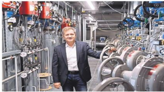
Das Kraftwerk kann eine ganze Kleinstadt versorgen. Über Wärmetauscher wird das heiße Wasser in das Fernwärmenetz geleitet. Geschäftsführer Wolfgang Geisinger ist stolz auf den Wirkungsgrad von 90 Prozent.
